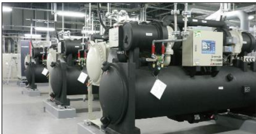
INVターボ冷凍機による高効率な熱源利用
