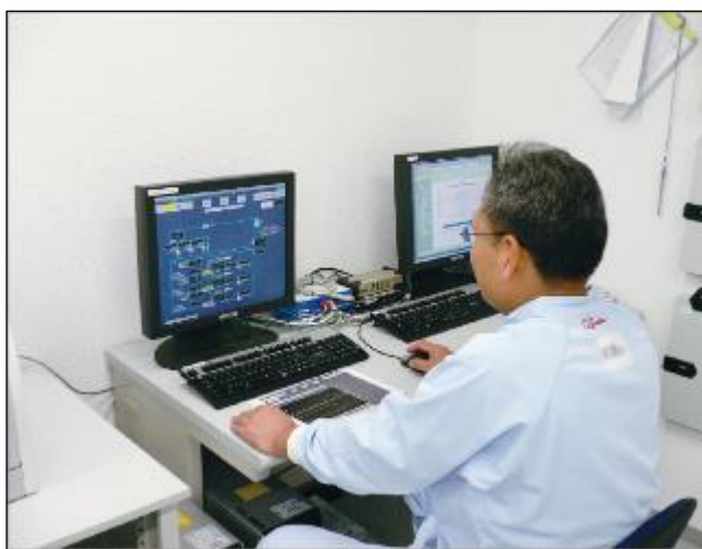
中央監視装置によるマネジメントシステムを導入
